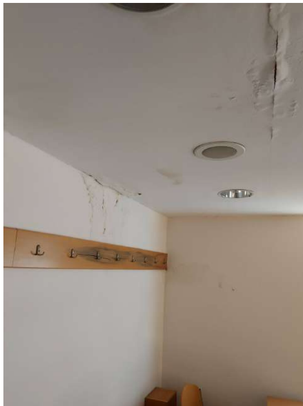
Slika 8: Tragovi curenja vode uz zajednički zid terase i velike dvorane
